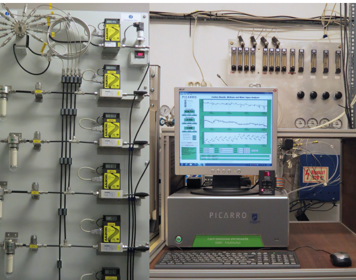
5. fénykép. Szén-dioxid / metán mérések az ICOS számára. Jobbra háttérben a régi, balra az új gázút-vezérlő és áramlásmérő rendszer.
